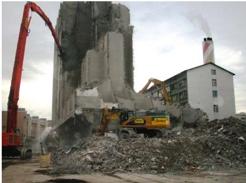
Im Vordergrund: Rückbau des grossen Silogebäudes direkt an der Dreirosenbrücke. Im Hintergrund (rechts): Das letzte Gebäude, das noch von den Archäologen genutzt wird (Bild: Ecosafe Gunzenhauser AG)
